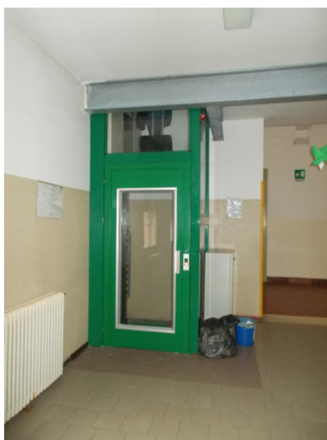
Esempio elevatore interno edificio
